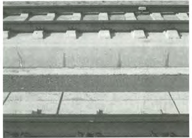
〈그림 17〉 슬래브궤도 균열
